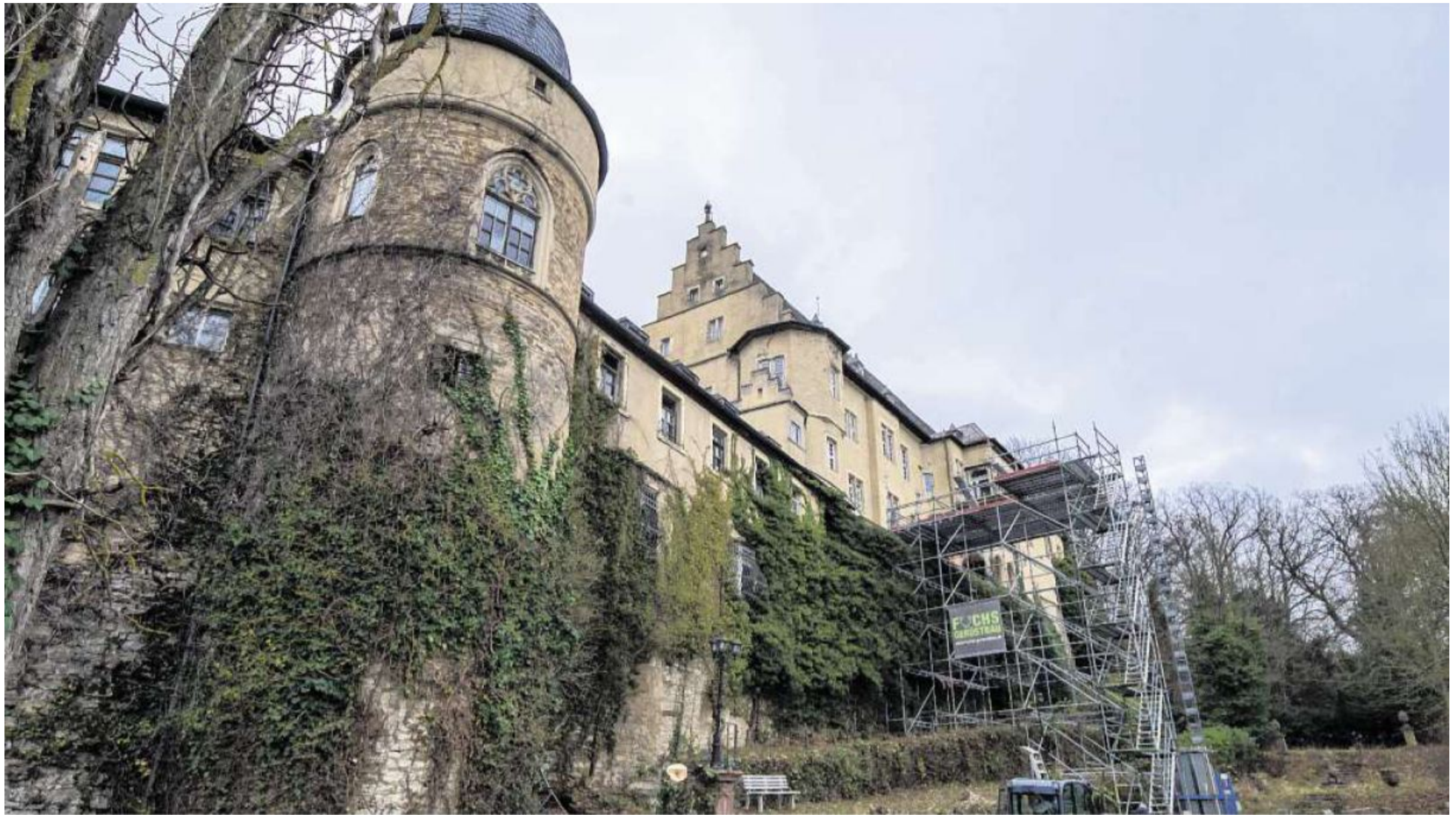
2017 drohten Teile der Vorburg einzustürzen. Der Staat finanzierte mit 700 000 Euro die dringendsten Reparaturen. Weitere 910 000 Euro flossen 2019 in Notsicherungsmaßnahmen. FOTO: A. ANDERS
